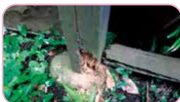
柱脚の腐朽を調査
