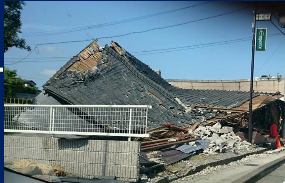
益城町倒壊住宅
