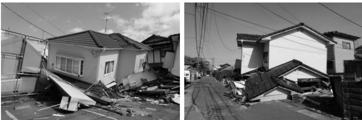
写真 熊本地震における倒壊した新耐震基準の木造住宅の状況 （出典：平成28年熊本地震建築物被害調査報告（速報）
