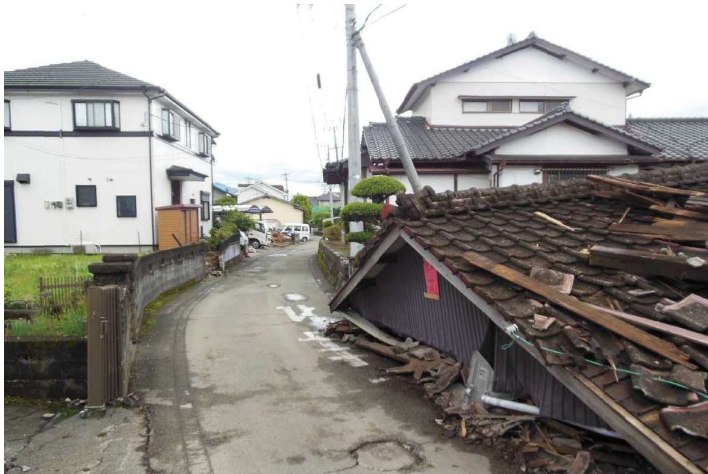
屋根部分のみ残して倒壊
