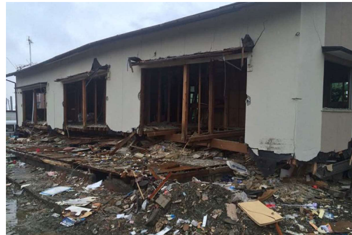
1階部分がすべて倒壊
